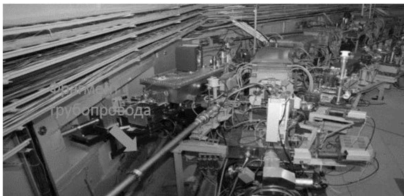
Рисунок 1 – Оборудование для реализации телеметрической системы
