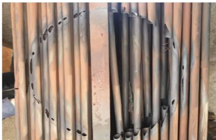
Рис.1 Эрозионный износ трубного пучка
