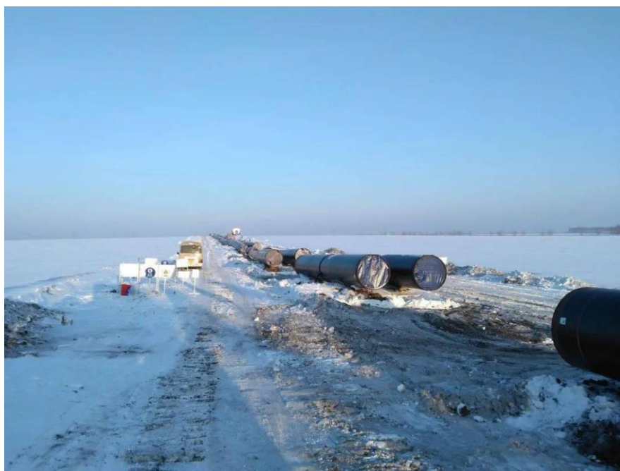
Рисунок 2. Газопровод «Восточный фронт» в Арктике Источник : https://www.sohu.com/picture/436094897
