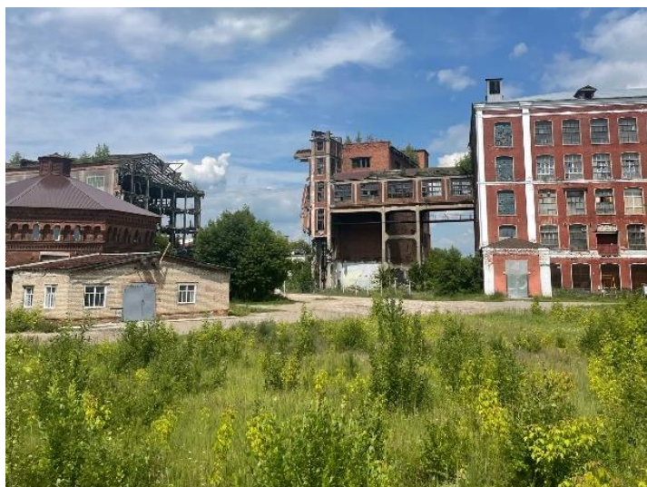
Рисунок 3 – Сохранившиеся и разрушенные элементы производственных корпусов
