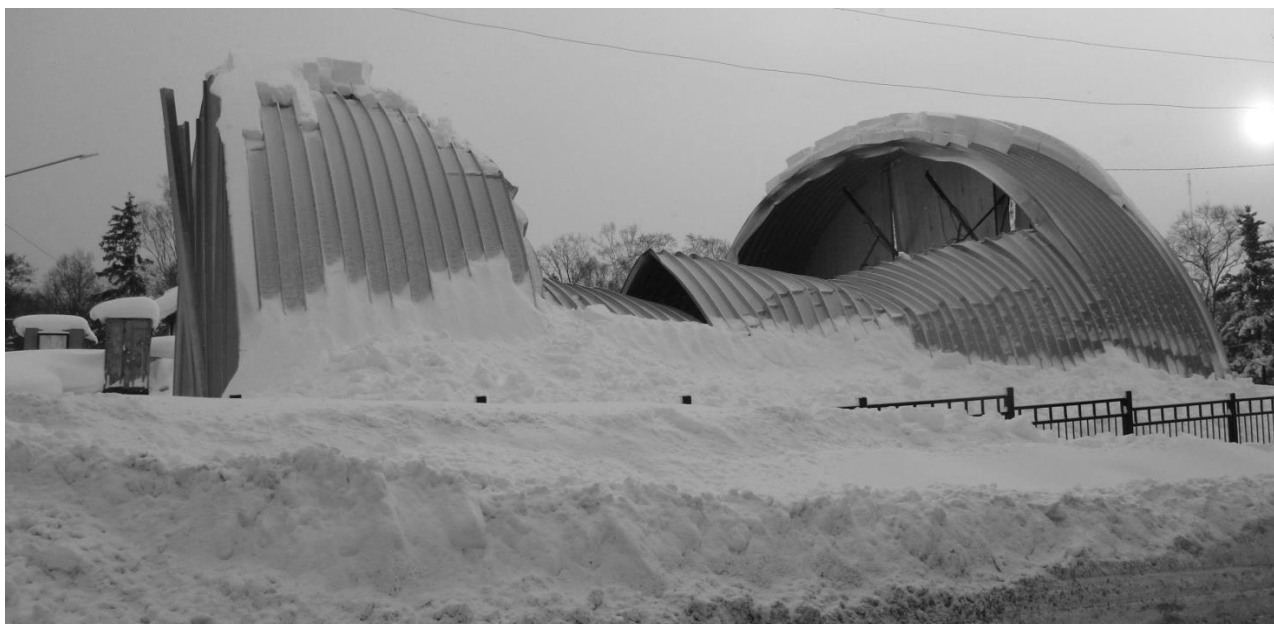
Рисунок 1 – Ангар в городском парке после обрушения.
