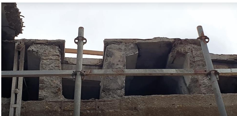
Рис. 2 (Источник: https://dzen.ru/video/watch/642c6d28d1ccd54a5e2179d9?sid=119543555474218505&t=74 ) – Дефекты железобетонных балок Краснопресненского путепровода
