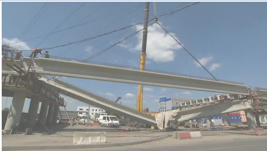
Рис. 3 (Источник: https://vm.ru/news/976767-chast-mosta-obrushilas-na-simferopolskom-shosse-v-stolice ) – Обрушение железобетонной балки эстакады
