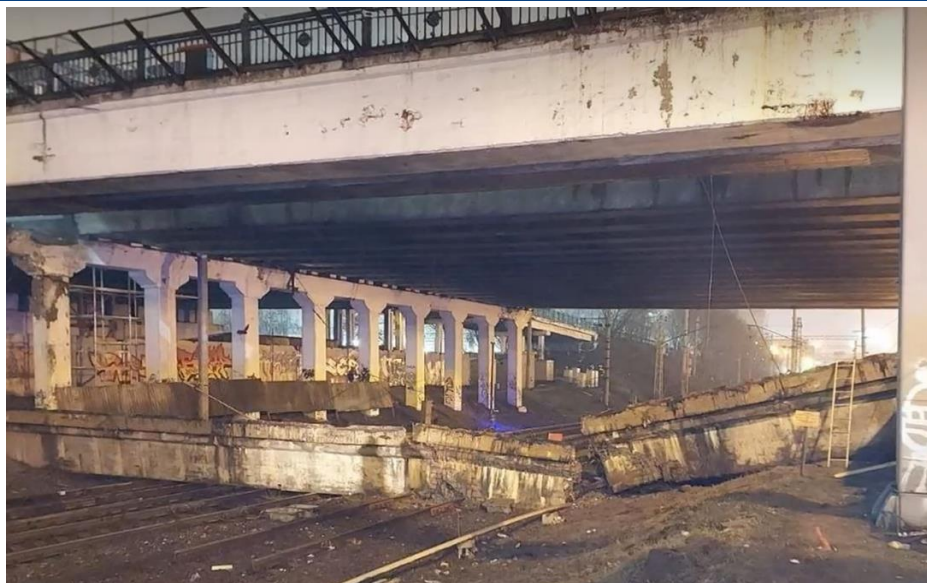
Рис.1 (Источник: https://moskvichmag.ru/gorod/na-platforme-begovaya-priamo-na-puti-obrushilas-balka-krasnopresnenskogo-puteprovoda/ ) – Обрушение балки Краснопресненского путепровода
