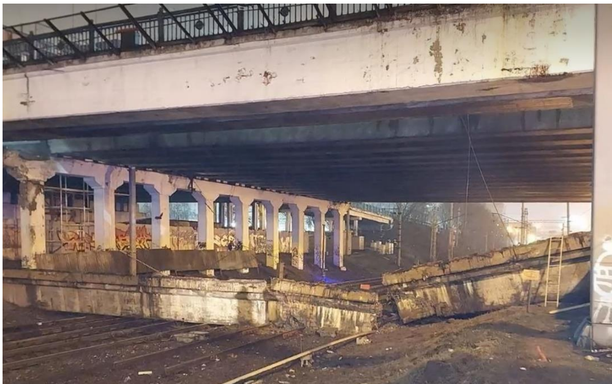
Рис.1 (Источник: https://moskvichmag.ru/gorod/na-platforme-begovaya-priamo-na-puti-obrushilas-balka-krasnopresnenskogo-puteprovoda/ ) – Обрушение балки Краснопресненского путепровода
