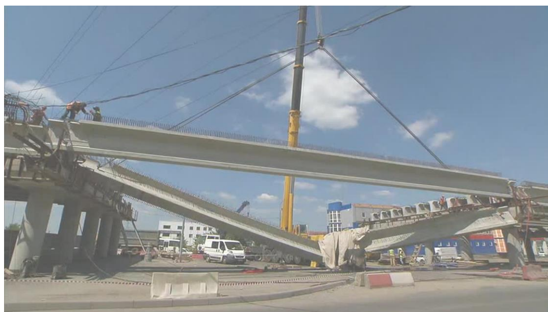
Рис. 3 (Источник: https://vm.ru/news/976767-chast-mosta-obrushilas-na-simferopolskom-shosse-v-stolice ) – Обрушение железобетонной балки эстакады
