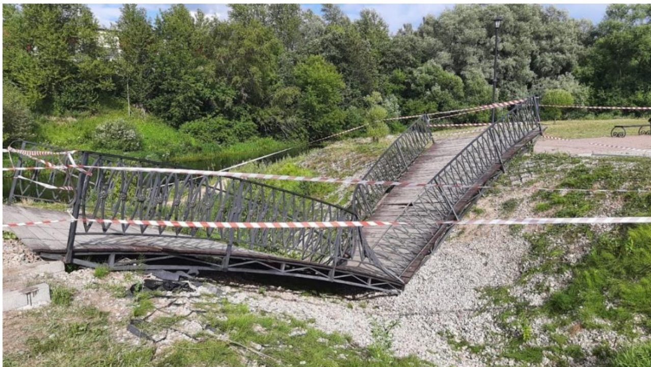
Рис. 4 (Источник: https://47news.ru/articles/234746/ ) – Обрушение пешеходного моста в Луге
