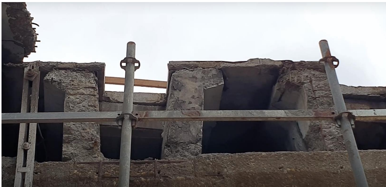
Рис. 2 (Источник: https://dzen.ru/video/watch/642c6d28d1ccd54a5e2179d9?sid=119543555474218505&t=74 ) – Дефекты железобетонных балок Краснопресненского путепровода
